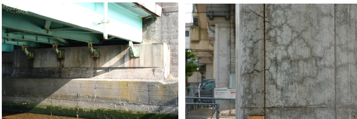
図12-1：道路橋の橋台部分（左）や鉄道構造物の橋脚（右）に見られるひび割れ
